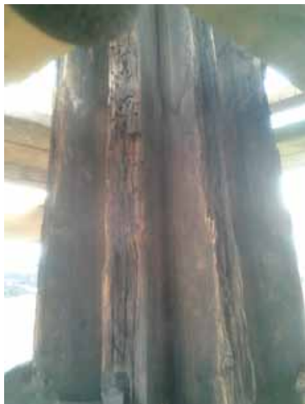
▲ W potowie spróchniały trzon wieży głównej
